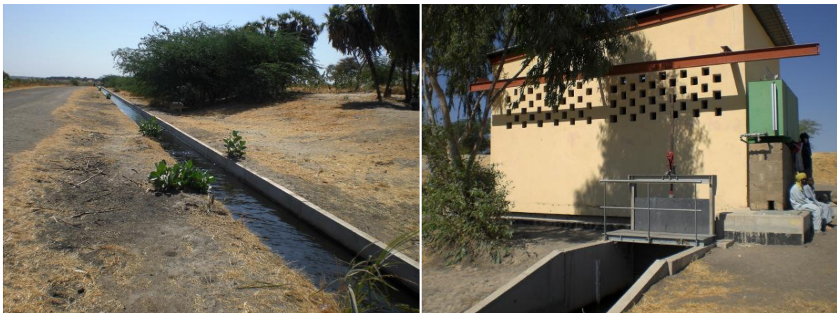
Figure 2. Canal et vanne pour l'irrigation avec l'eau du lac Tchad dans le polder de Bol (Photo: BGR)
